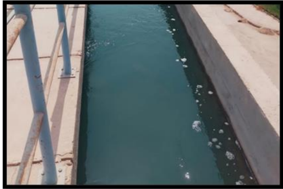
صورة (٢٧) أحواض البليستور في محطة تنقية مياه الشرب بمدينة العبور
