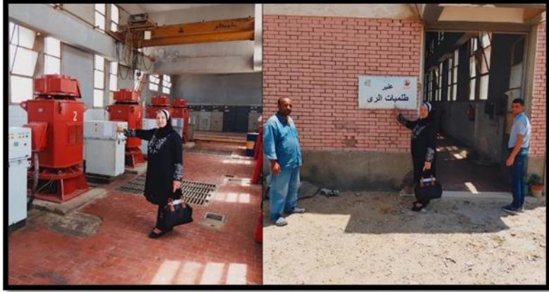
صورة (١٦) عنبر طلبات مياه الري بمحطة تنقية مياه السادس من أكتوبر القديمة
