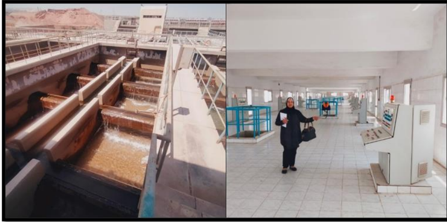
صورة (٢٠) المرشحات بمحطة مياه ٦ أكتوبر الجديدة
