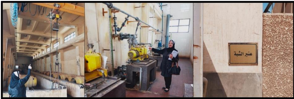
صورة (٢٥) عبير الشبة لمحطة تنقية مياه الشرب بمدينة العبور
