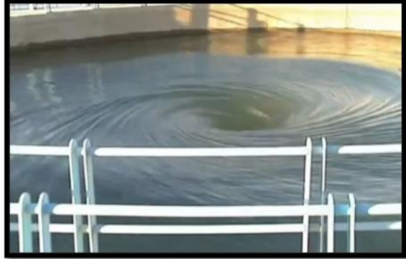
صورة (٢١) مرحلة الترشيح بمحطة تنقية مياه حدائق أكتوبر
