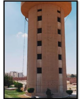
صورة (١٤) خزانات المياه المرشحة بمحطة تنقية مياه السادس من أكتوبر القديمة
