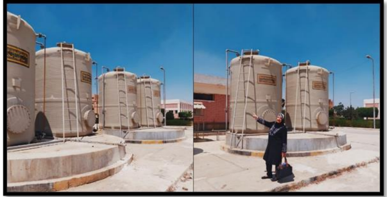
صورة (١٣) خزانات الشبة بمحطة تنقية مياه السادس من أكتوبر القديمة
