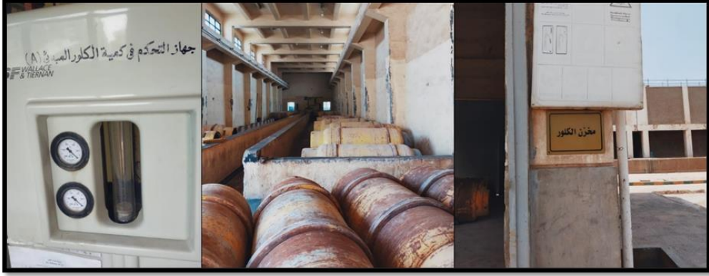
صورة (٢٦) مخزن الكلور لمحطة تنقية مياه الشرب بمدينة العبور
