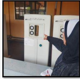
صورة (٣١) غرفة حقن الكلور في محطة تنقية مياه الشرب بمدينة العبور
