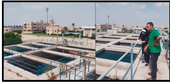
صورة (٢٨) أحواض مستطيلة صغيرة في محطة تنقية مياه الشرب بمدينة العبور
