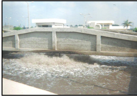
صورة (٢) : أحواض التهوية بمحطة معالجة مدينة أشمون.
