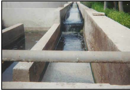
صورة (٩) : حوض الكلور بمحطة معالجة أشمون.
