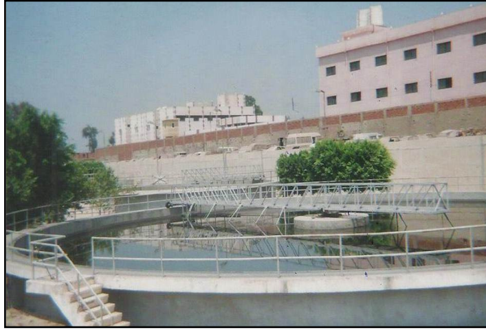
صورة (٧) : أحواض الترسيب النهائي بمحطة معالجة قويسنا.
