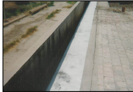
صورة (٨) : حوض الكلور بمحطة معالجة شبين الكوم.
