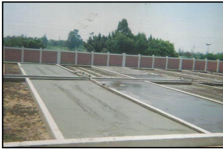
صورة (١١) : أحواض تجفيف الحمأة بمحطة معالجة قويسنا.
