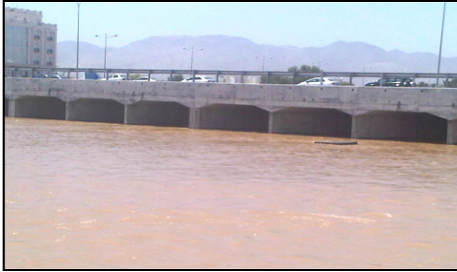
شكل (٩) : يوضح عبارات صندوقية Culvert بعد سقوط الأمطار على شارع ١٨ نوفمبر.
